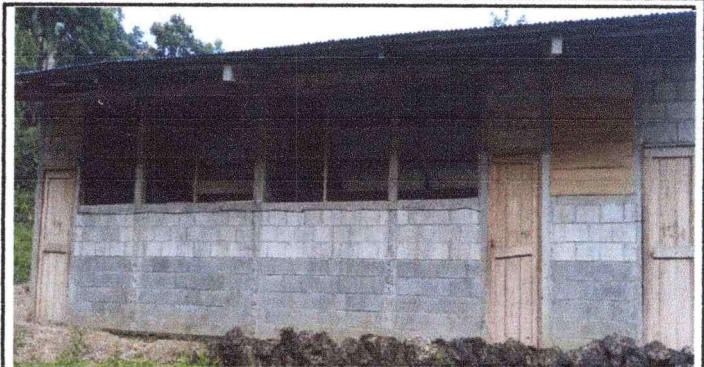
Foto 2: Se observa que el corredor se encuentra en mal estado.
